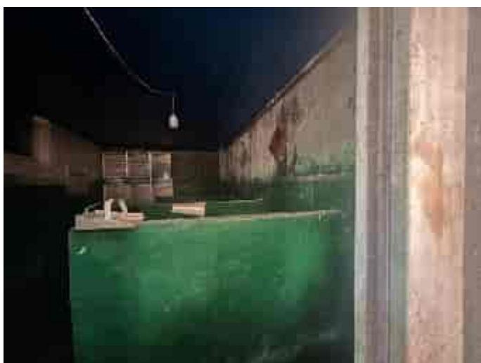
选厂危险废物暂存间
