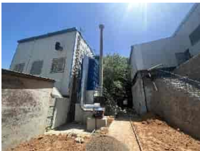
选厂破碎筛袋式除尘器
