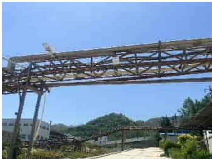
尾矿输送管道
