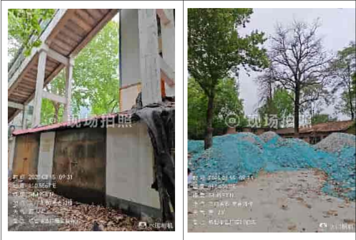
杨砦峪选厂危废暂存间
