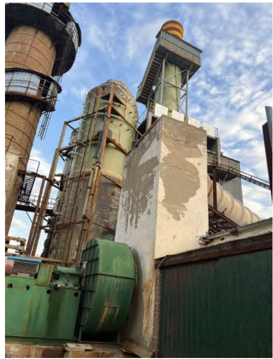
烘干焙烧废气处理设施及排气筒 (DA001)
