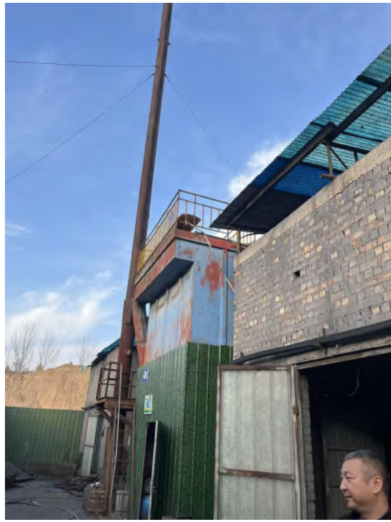
破碎工序除尘器及排气筒 (DA002)
