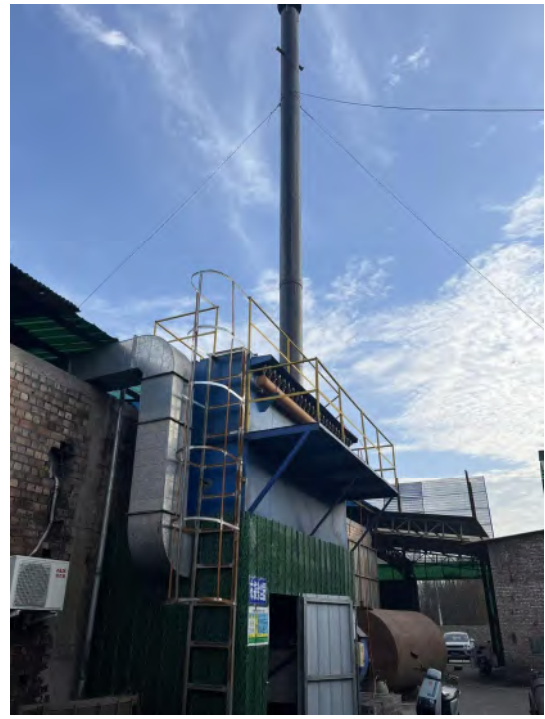
筛分工序除尘器及排气筒 (DA004)
