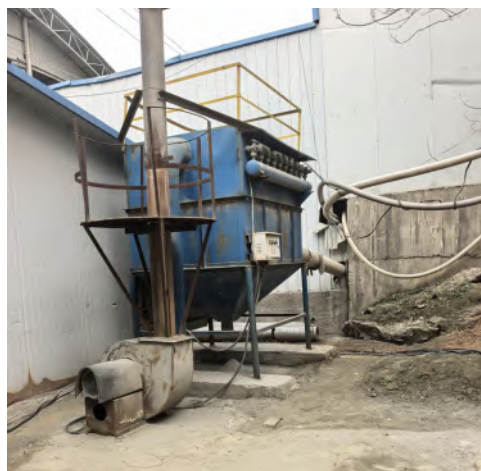
袋式除尘器+排气筒
